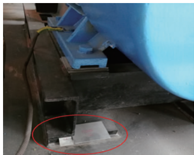
图4 框架基础翘曲变形
