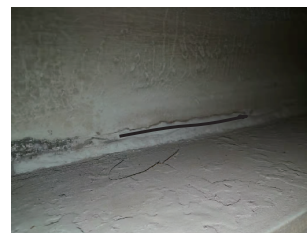
图 2 现场车体东侧开裂处
