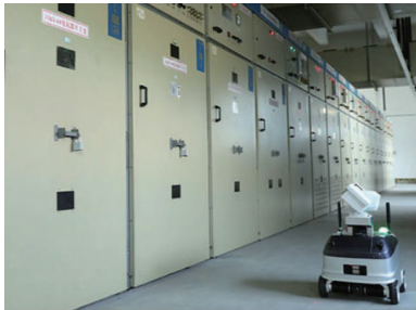
图 4 电力巡检机器人测试
